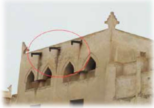
( شكل رقم 2 ) تسرب مياه الأمطار من مزايب الصرف التالفة وتأثيرها الضار علي الواجهات " بيت الشيخ عيسى " مدينة المحرق – الإمارات
