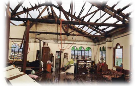
( شكل رقم 3 ) : تدمير منزل تراثي ومحتوياته بفعل العواصف الشديدة والأمطار القوية خلال نشوب إعصار الفلبين 2013م. المصدر: جونيور, خوسيه لويز بيدروسولي , انتومارشى , كاثارين 2016م , " دليل إدارة المخاطر للتراث الثقافي " , كتاب , ترجمة : ماري عوض , المركز الدولي لدراسة حفظ وترميم الممتلكات الثقافية, المعهد الكندي لحفظ التراث كندا.
