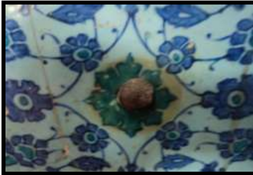
صورة رقم (21) توضح ظهور بقع بلون أصفر حول المسامير وبهتان للألوان السطحية
